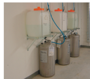
Installation fixe dans une boîte de lavage de voitures.
